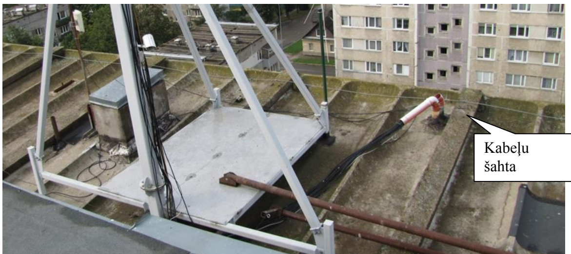
att.4 Kabeļu šahta
